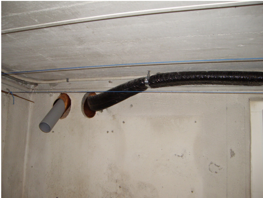
Hauseinführung von Abgasleitung und Solarleitung
