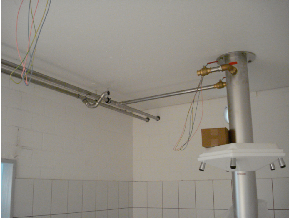
Sanimatic Multiduschstation mit Chromstahlrohren angeschlossen
