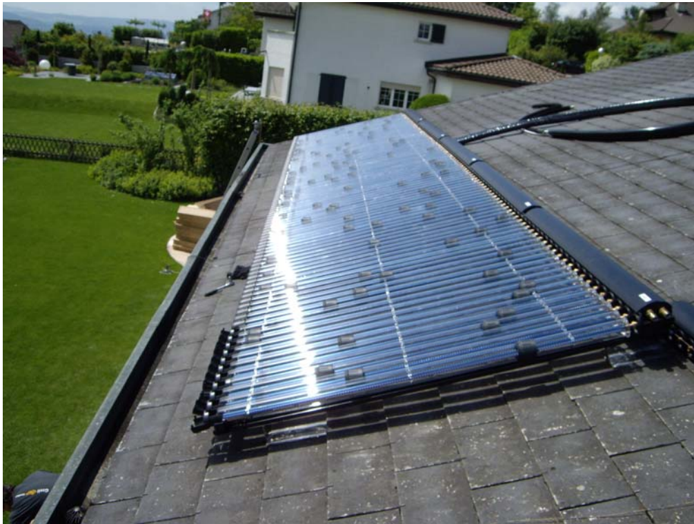
Fast fertigmontierte Vakuumröhren auf dem Dach
